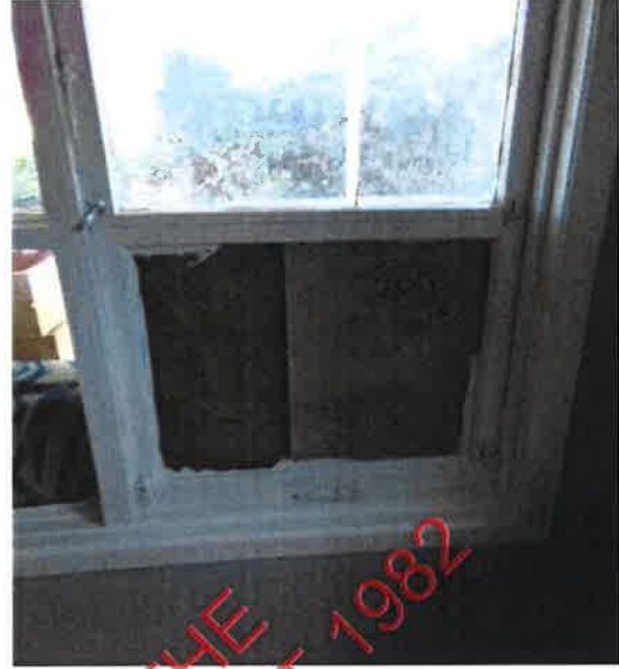
Q126 Bedroom 4 Broken Windows
